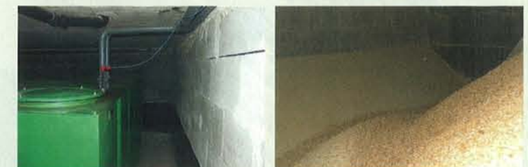
La citerne à mazout, une fois le bâtiment assaini, peut laisser la place à un stock de pellets.
